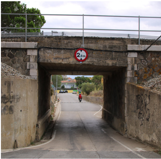
Aquest pont de Vilajuïga, en ser estret i baix, impedeix el pas de grans camions ACN.
