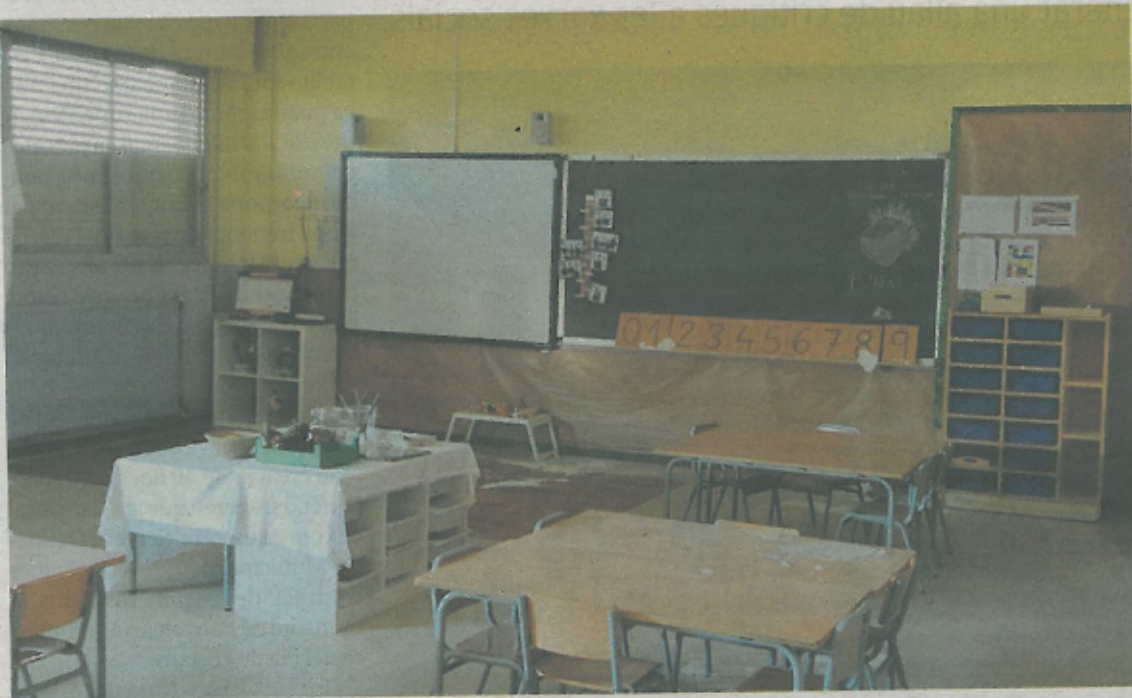
Una de les aules afectades per les filtracions d'aigua.
