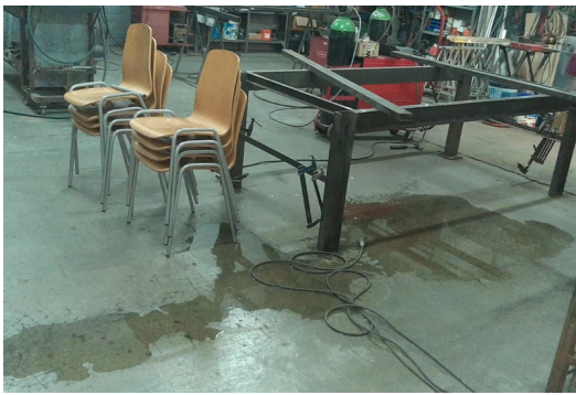
Un dels espais de l'equipament de Can Sagrera amb goteres ACN.
