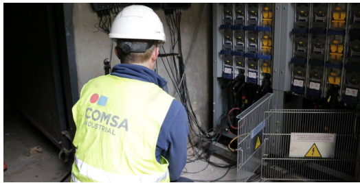
Interior del transformador de la Font de la Pólvara ACN.
