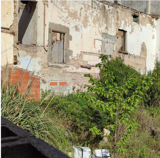
El pati interior de la casa, sense teulat arran d'un esfondrament, a Palafrugell E.A.
