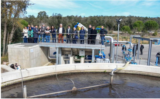
La nova depuradora de Can Carbonell CEDIDA.
