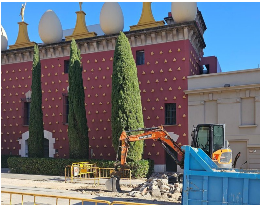
Les obres que han causat l'avaria CEDIDA.
