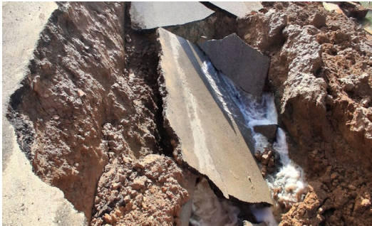
Esfondrament parcial d'una calçada a Anglès que ha deixar sense aigua els veïns ACN.
