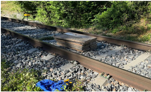
Una de les imatges del presumpte sabotatge a l'R3 que ha compartit Adif al seu compte de la xarxa social X. @INFOADIF.
