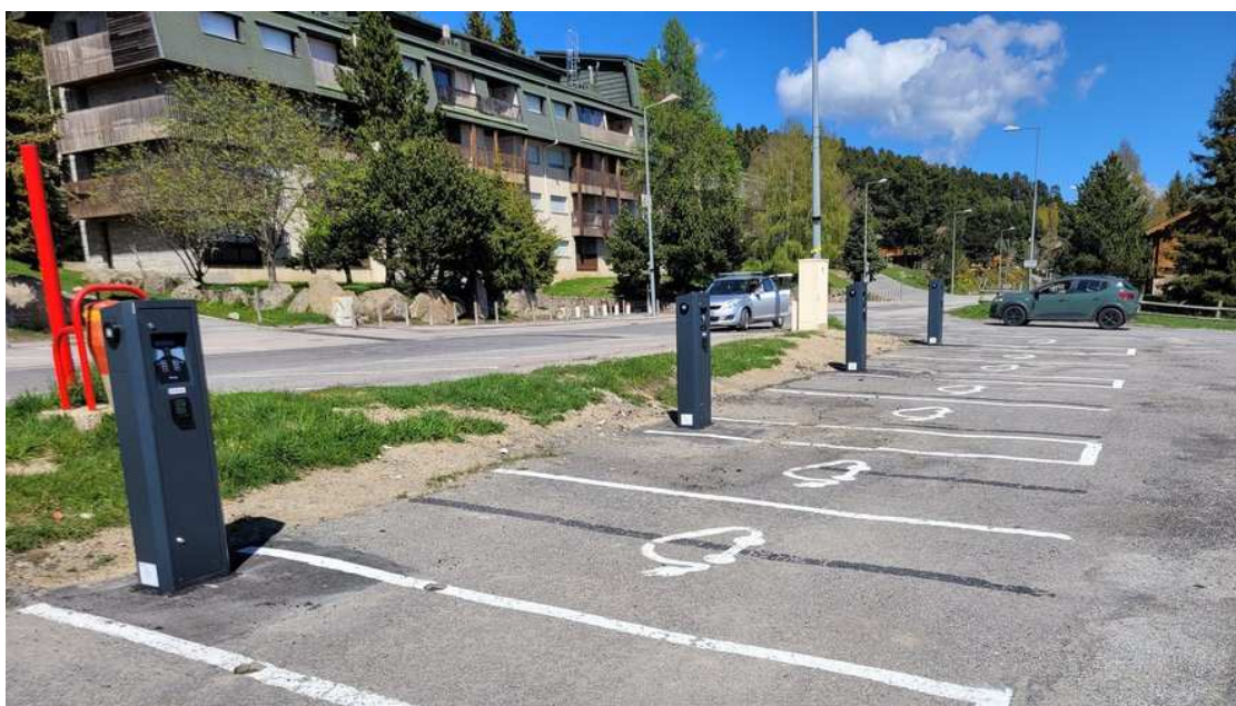
La batterie de bornes de recharge sur le parking de Pyrénées 2000 en attente de mise en service.
