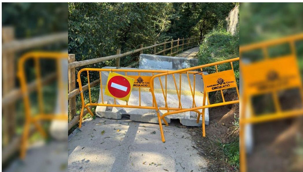
Tanques que impedeixen l'accés al corriol. / DdG
