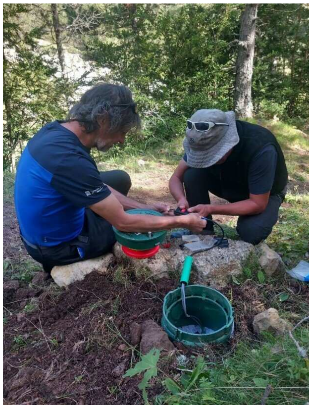
Instal·lació de nous comptadors al Parc Natural del Cadí-Moixeró / @PNCadiMoixero
